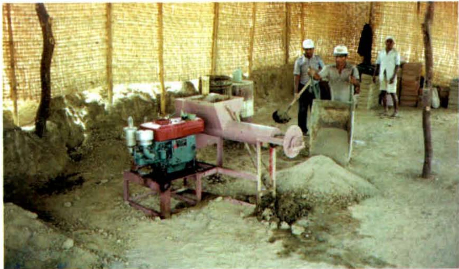
■ Mezcladora accionada por motor, en plena operación.
