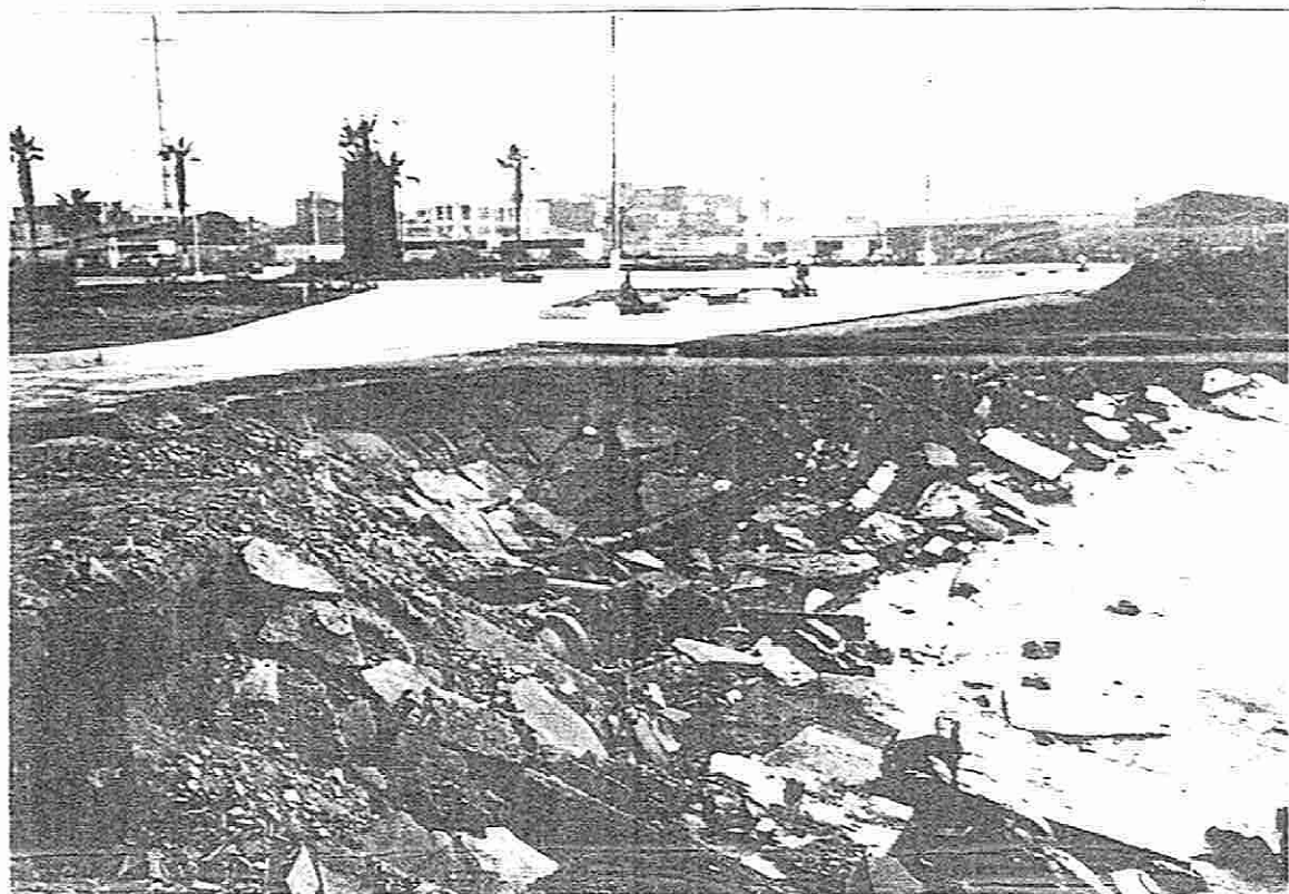
Muro de enrocado colapsado en la Plaza Grau de Chimbote
