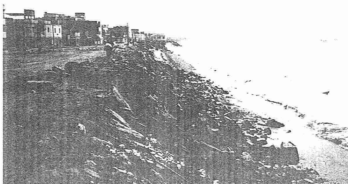
Muro de enrocado destruidos por las bravezas al Sur de la Plaza Grau.
