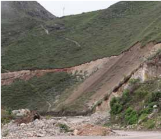
Corte de la ladera y depósito de material al costado de la vía en la carretera Balsas - Celendín, Cajamarca. Foto: M. Stucchi [2012].
