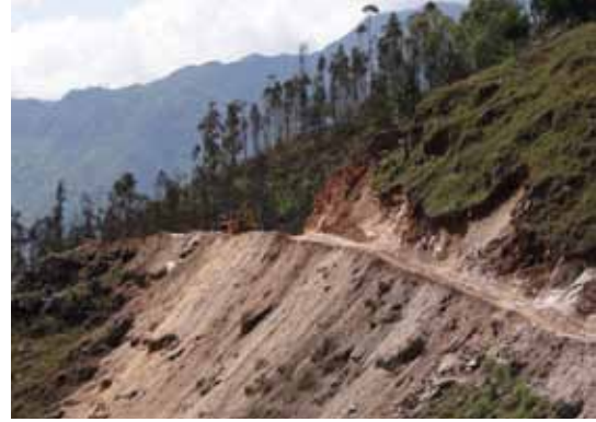
Construcción de la carretera Choropampa - Chucén, Cajamarca. Nótese cómo se arroja el material excedente a la quebrada sin ningún tipo de previsión ni control. Foto: M. Stucchi [2012].
